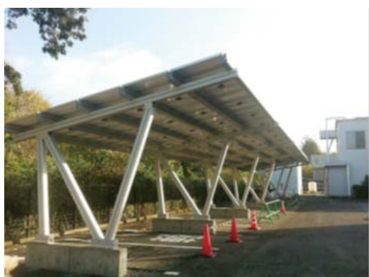
【駐車場（カーポートの上部に設置）】
